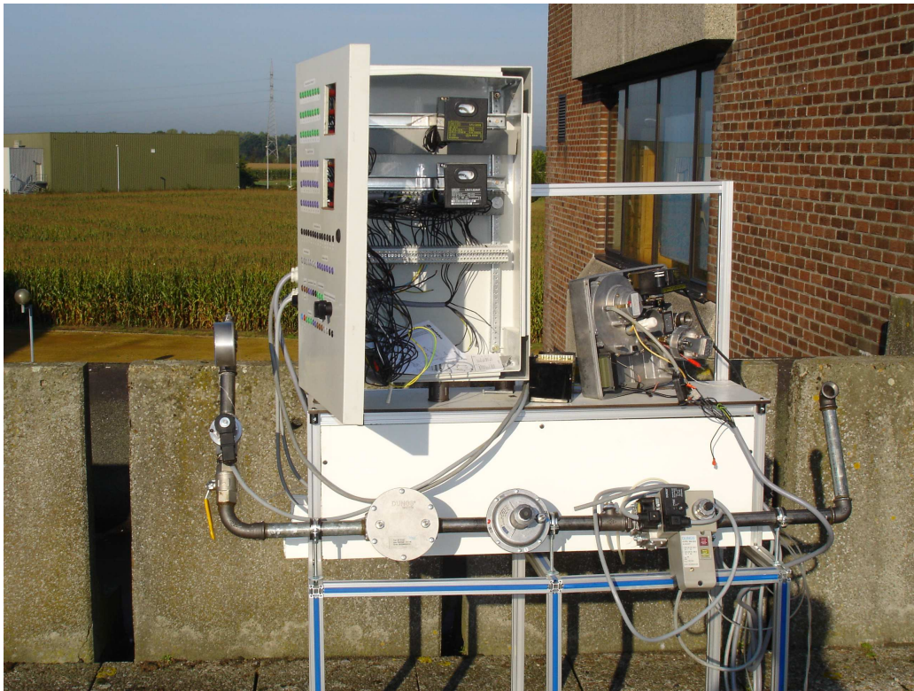
figuur 1.2 de gasstraat in het begin
