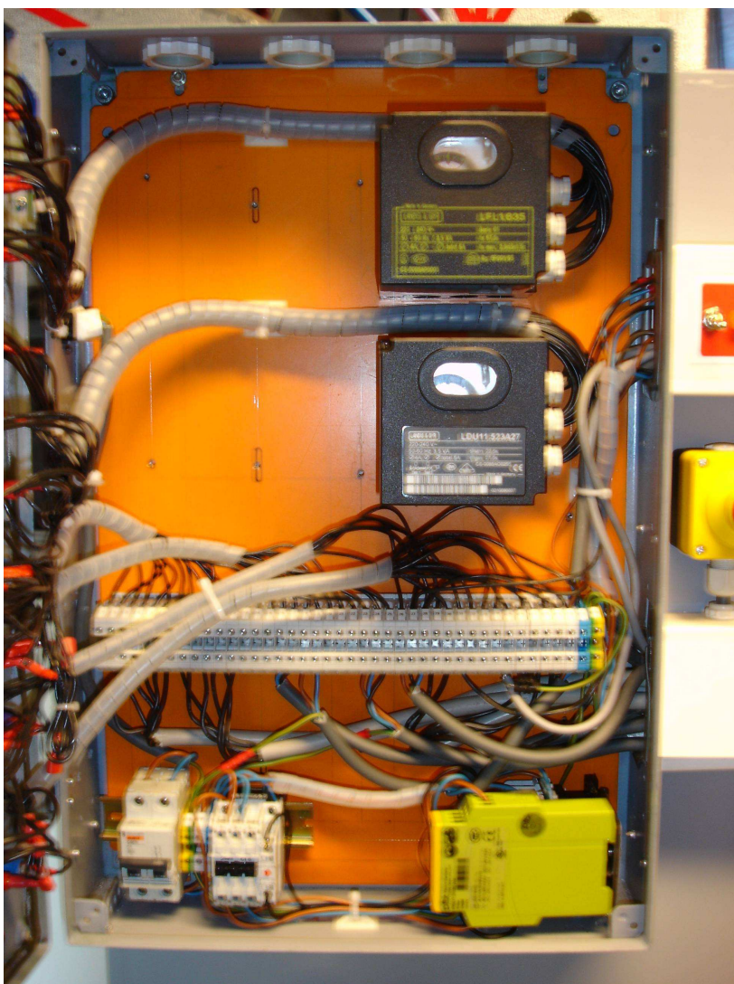
Figuur 3.4 de binnenkant van de nieuwe elektriciteitskast
